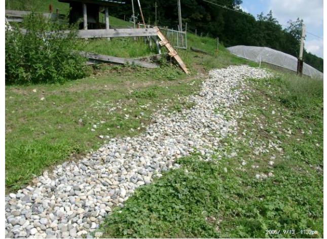
Foto M8: Siedlungsgebiet Halde Im oberen Teil wurden die Risse teilweise mit Sickerkies saniert.
