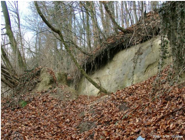
Foto L7: Hang NW' Fabrickgebäude Rutschung in der steilen Hangpartie.
