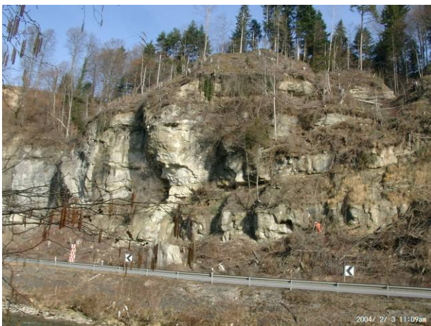
Foto R13: Felswand Dietenei Die Kantonsstrasse verläuft sehr nahe am Felsbereich.
