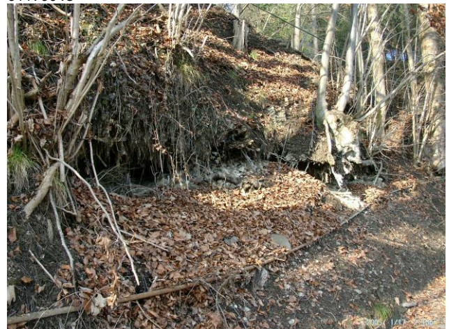
Foto Wo16: N' Kommetsrüti Risse im Hang oberhalb des Fuswegs.
