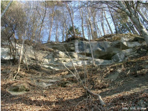
Foto R15: Felswand W' Muffehus Ein stark strukturiertes Felsband, bestehend aus wechsellagernden Sandsteinen und Mergeln, im oberen, steilen Hang direkt über der Kantonsstrasse. Aus einer Sandsteinlage hat sich im März 2005 ein Blockschlag ereignet
