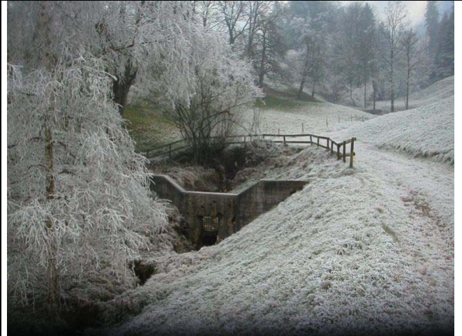
Foto 04.12.16_41 Kleinsammler im Vogelwaldbach, Bauwerk 73007
