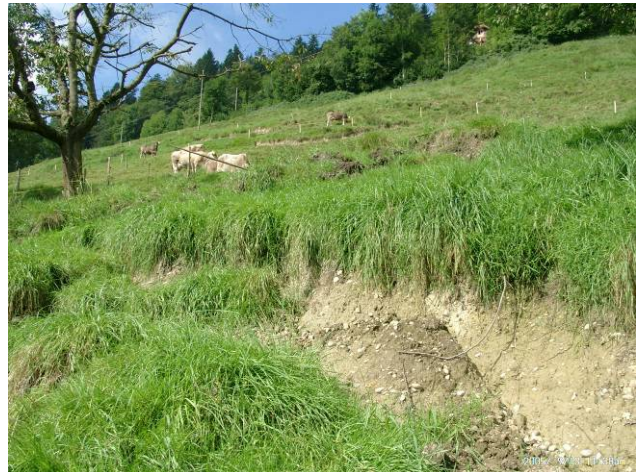
Foto Wo13: Mittler Kommetsrüti Unwetter August 2005: Der ganze Hang ist von neune Rissen durchsetzt
