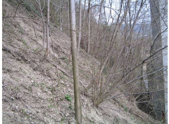
Foto Wo20: Silo der Landi Hinter dem Siloturm hat sich gemäss einem Anwohner vor ca. 25 Jahren eine Spontanrutschung ereignet. Die Rutschung ist auch heute noch aktiv (krummwüchsige Bäume)
