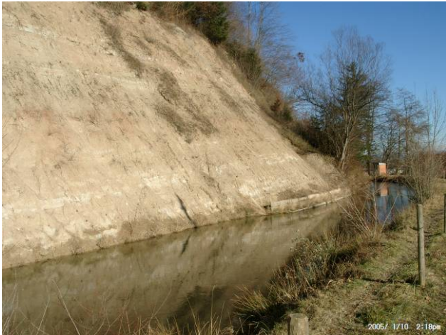
Foto L1: W' Elektrizitätswerk Am Nordufer des Kanals ist die Lockergesteinsdecke der ca. 15 m hohen Böschung vollständig erodiert und der Mergel freigelegt.
