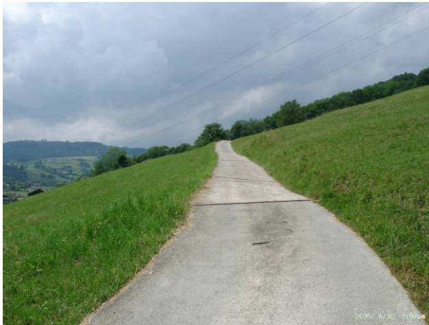
Foto M1: Mueshofhalde Die nach Löchlihalde hinaufführende Strasse ist durch permanente Rutschprozesse aufgewellt.
