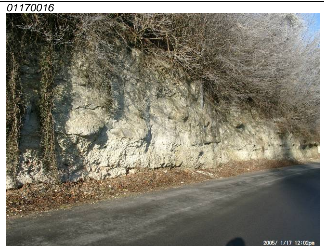
Foto We10: Kurve auf Strasse W' Schwandehof, Kote ca. 610 Dünnbankige Mergelschichten wechsellagern mit knauerig herauswitternden Sandsteinbänken.
