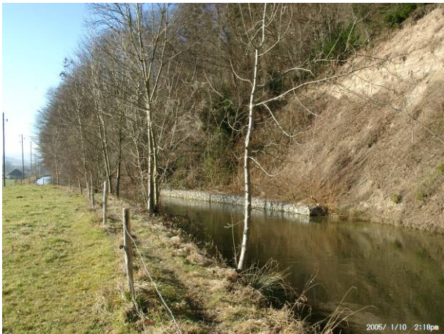
Foto L3: W' Elektrizitätswerk Steinkorbmauer am Fuss des Kanals, am W' Ende des freigelegten Hanges
