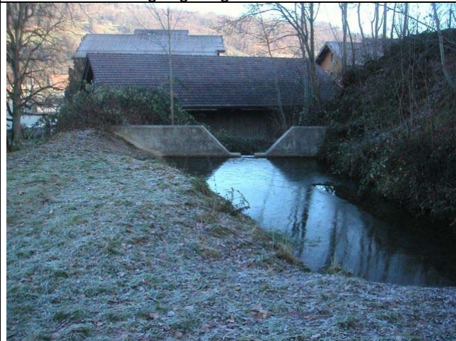
Foto 05.01.05_52 Kleinsammler am Rothärdtbach, nahe Hübeli. Bauwerk 77003
