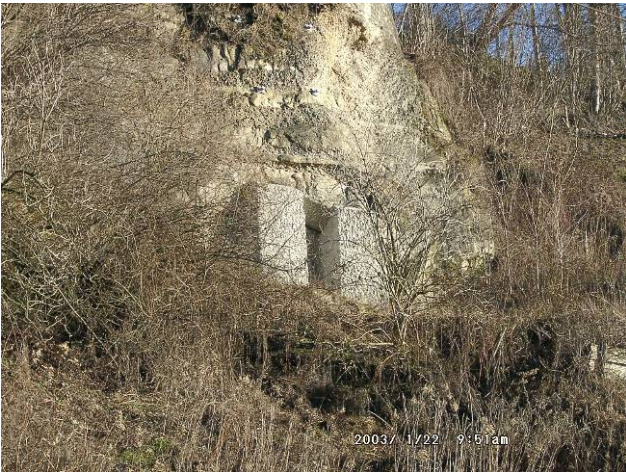
Foto R7: Werthenstein Felswand hinter dem Gasthaus zur Emme. Ein Überhang wird mit zwei Betonpfeilern gestützt.
