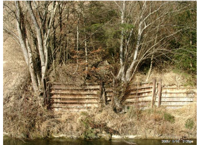
Foto L2: W' Elektrizitätswerk N' der freigelegten Hangfläche steht eine Eisenpalisade, die durch die Rutschbewegung des rückseitigen Lockergesteins stark nach vorne gedrückt wird.
