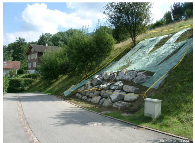
Foto M12: Geissbühl, Malters Frisch sanierter Hangausbruch der Strassenböschung bei Geissbühl nach den Starkniederschlägen August 2005.
