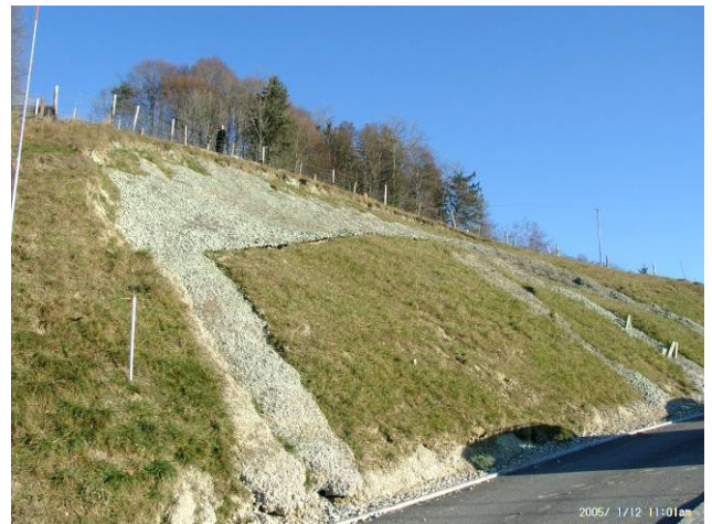
Foto M4: Siedlungsgebiet Halde Januar 2005: Böschungsbruch an der neu angelegten Zufahrtsstrasse.
