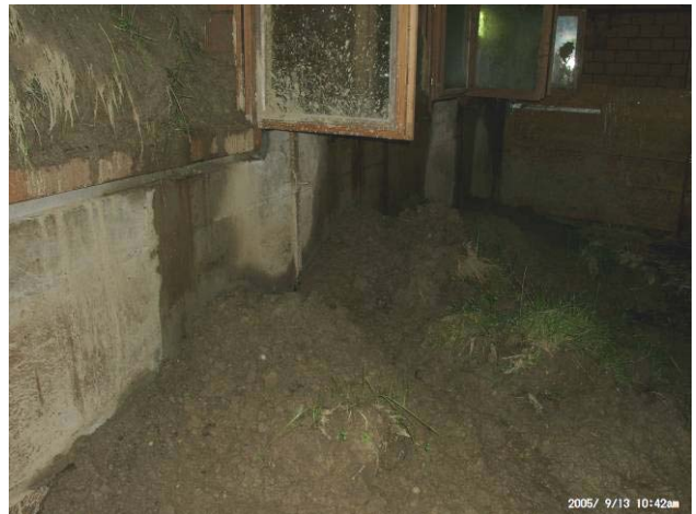
Foto Wo11: Hinter Kommetsrüti, Kote ca. 620 Das Murmaterial drückte teilweise durch die offenen Fenster in den Stall hinein.
