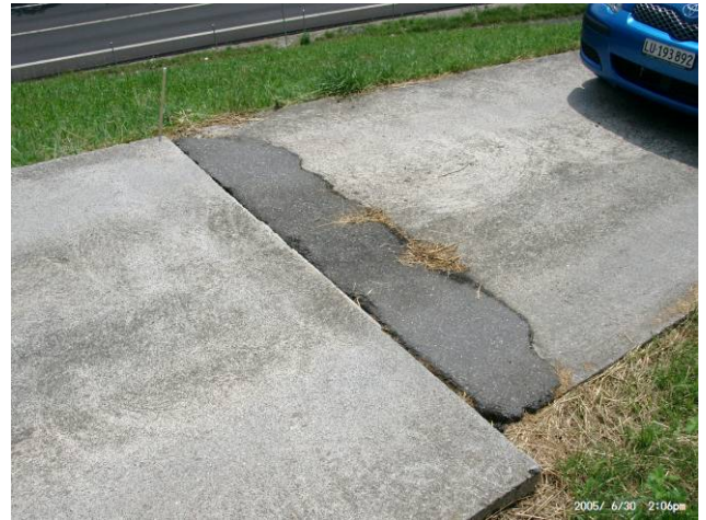
Foto M2: Siedlungsgebiet Halde Die Betonelemente wurden durch die Bodenbewegungen gegeneinander versetzt
