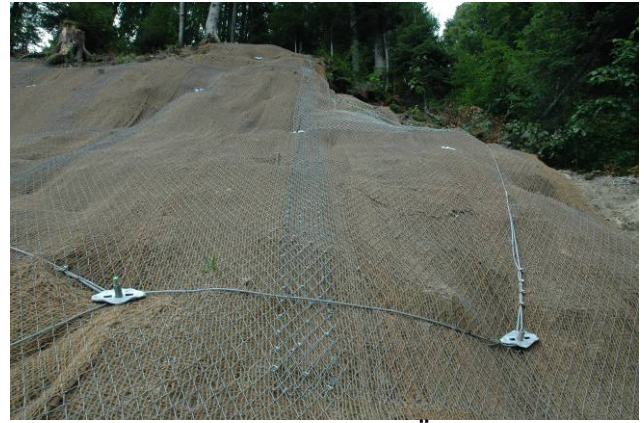
Foto We8: Langnauer Wald, Ängelgraben Kote ca. 590 m ü. M. Das mit einem Tecco- Netz überspannte Kokosmatte wurde in den Fels rückverankert. Auch nach den Unwettern vom August 2005 ist der Bereich stabil.
