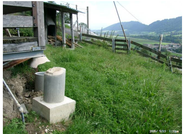
Foto M10: Siedlungsgebiet Halde 13. September 2005: Der Betonpfeiler ist abgebrochen und hat sich deutlich hangabwärts bewegt.
