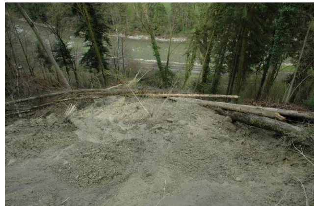
Foto We6: Langnauer Wald, Ängelgraben, Kote ca. 580 m ü. M. Die Bahnlinie verläuft am Hangfuss und ist durch das remobilisierte Erdmaterial bedroht.
