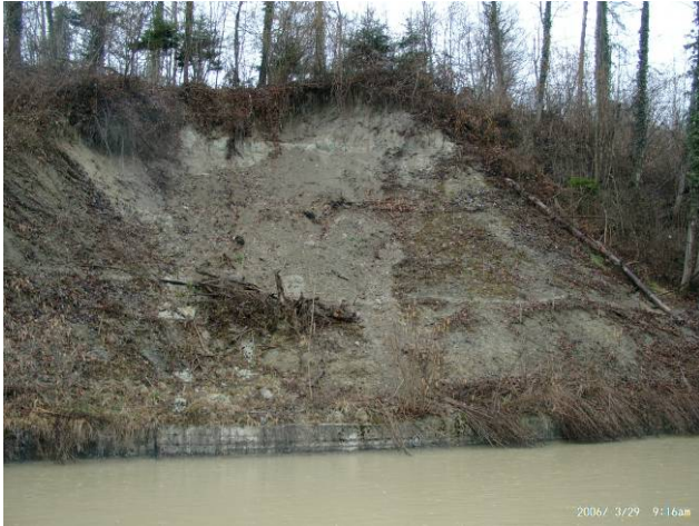
Foto L5: W' Ufer Kanal, Ämmenweid Erosionsfläche in der steilen Böschung des Kanals.
