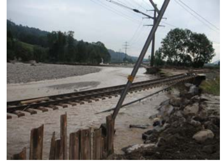
Abbildung 7: Bei Malters schuf sich die Kleine Emme ein neues Bett und zerstörte 80m vom ursprünglichen Lauf entfernt die SBB-Trasse
