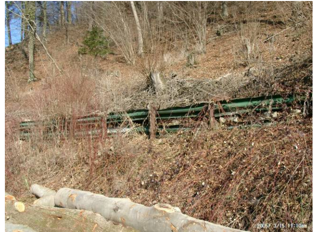
Foto R2: Hasenwald Ein aus Leitplanken erstelltes Bauwerk oberhalb der Güterstrasse ist komplett hinterfüllt.
