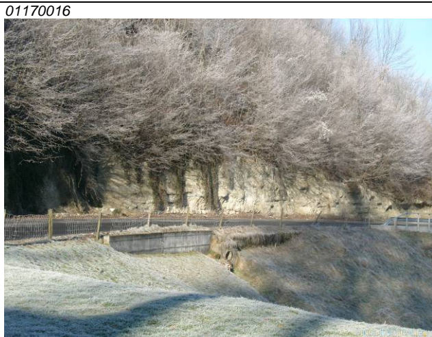
Foto We9: Kurve auf Strasse W' Schwandehof, Kote ca. 610 Richtung Wolhusen. Entlang der Strasse sind Felspartien aufgeschlossen, die zu Steinschlag auf die Strasse führen.
