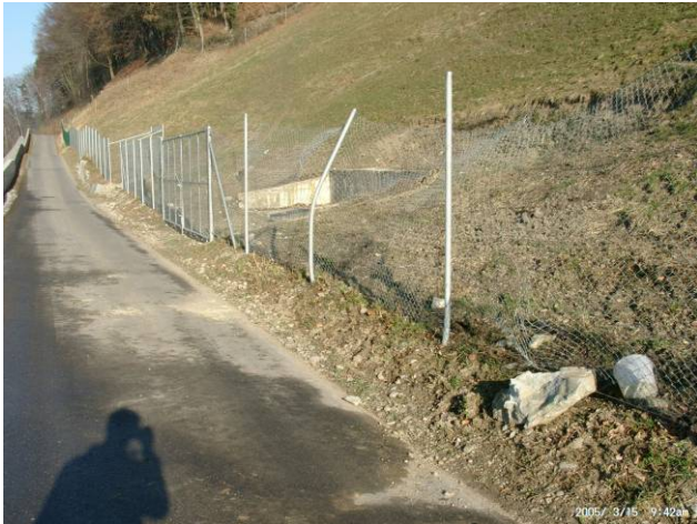
Foto R19: Unterhalb Felswand W' Muffehus Der Drahtmaschenzaun entlang dem Weg wurde durch den Block in 1 m Höhe getroffen und umgelegt. (Der Zaun wurde nachträglich wieder aufgestellt.)
