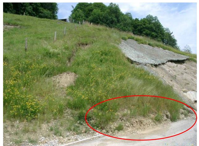
Foto M6: Siedlungsgebiet Halde Juni 2005: Die Böschung ist weiter abgesackt, Erdmaterial rutschte in die Strasse hinein.
